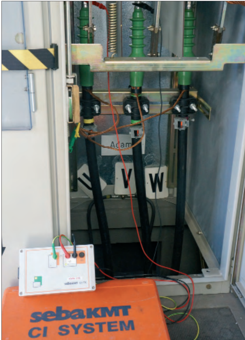
Bild 2: Beim Anschluss des Impulsgenerators in der Ortsnetzstation kommt es nicht mehr zur Verwechslung der Polarität
